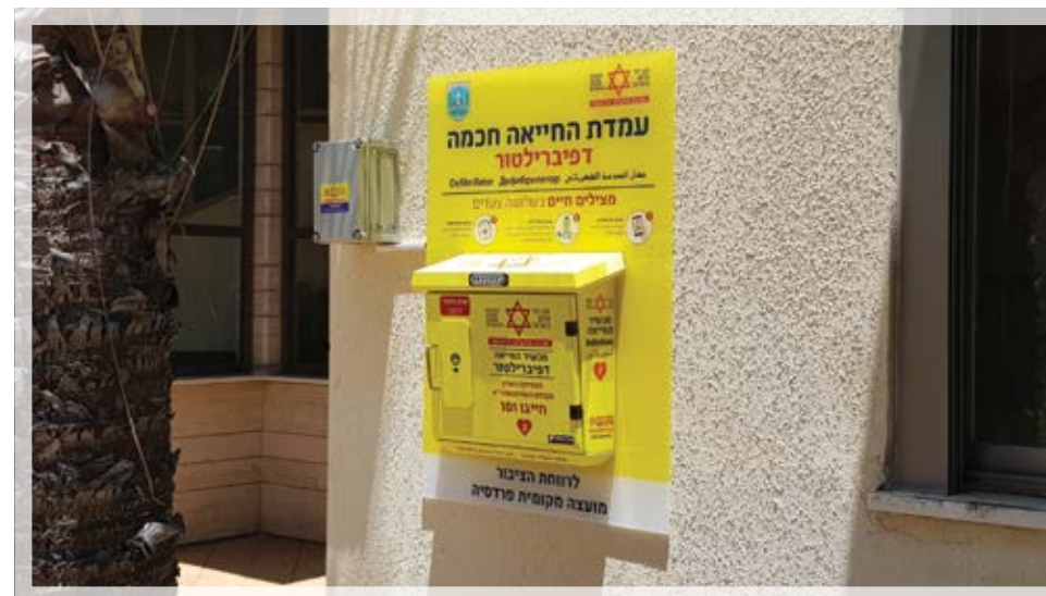
הוצב דפיברילטור חיצוני בכניסה למועצה לשימוש בעת הצורך 24/7
